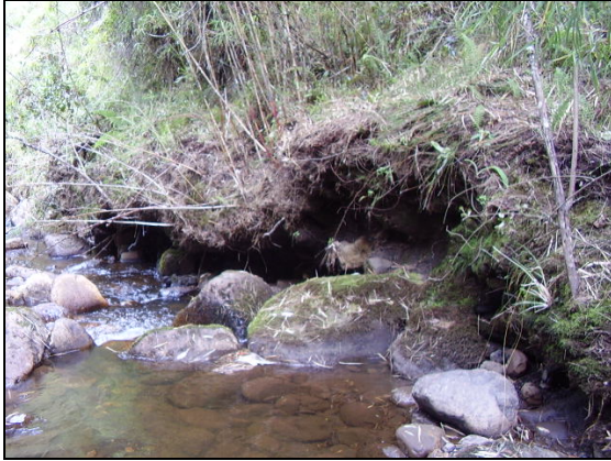
Fotografía 6 - 50. Socavación de la pata de un talud por corriente de agua.
