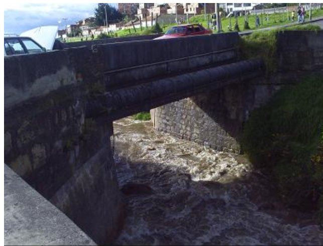
Fotografía 9 - 3. Cruce carrera 8 A este con el río San Cristóbal: Estructura tipo box en el cruce de carrera 8 A este con Calle 12 Sur.
