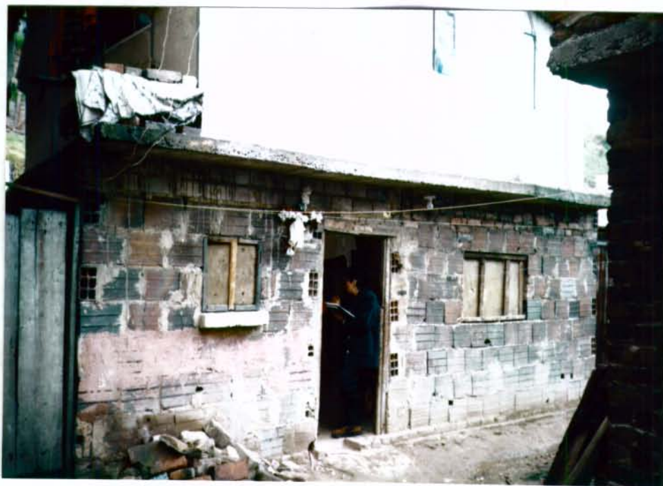
Transversal 7A No. 4-38 Sur. Propietario: Maria del Transito Paez Anteriormente esta vivienda fue afectada por un deslizamiento. Actualmente la casa esta construida, el primer nivel en mamposteria y el segundo prefabricado el cual puede presentar una inestabilidad
