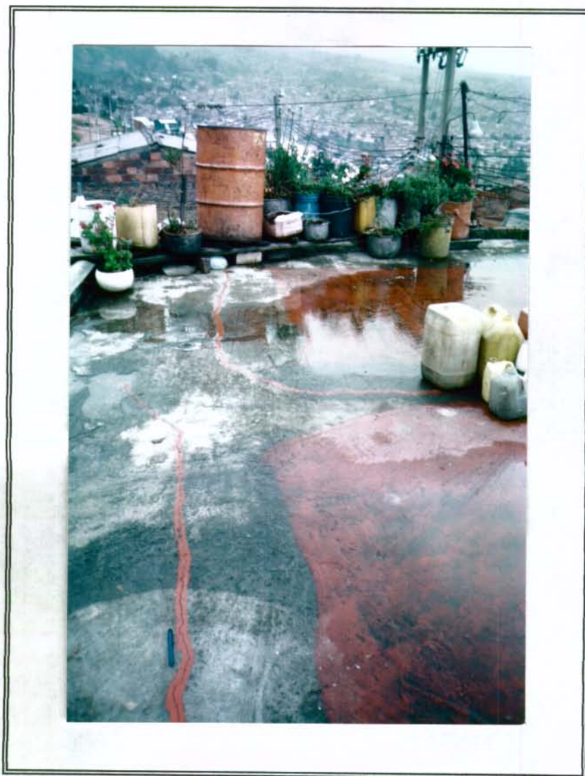
Transversal 7A Este No. 4-56 Sur. Propietario: Pedro Antonio Contreras Se observa la fisura en la placa de la sotea, la cual es la cubierta de la vivienda.
