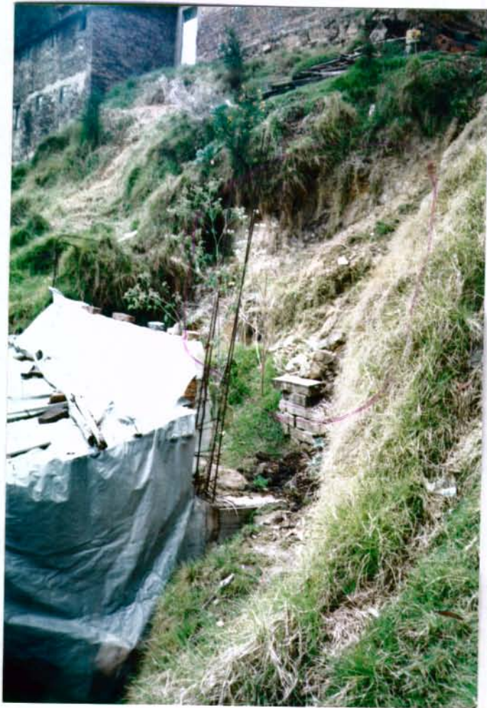
Cra. 7A No. 4-62 Sur. Propietario: Maria Cecilia Poblador. La vivienda se encuentra en riesgo por que en esta área se estan presentando los deslizamientos como se observa en la fotografía
