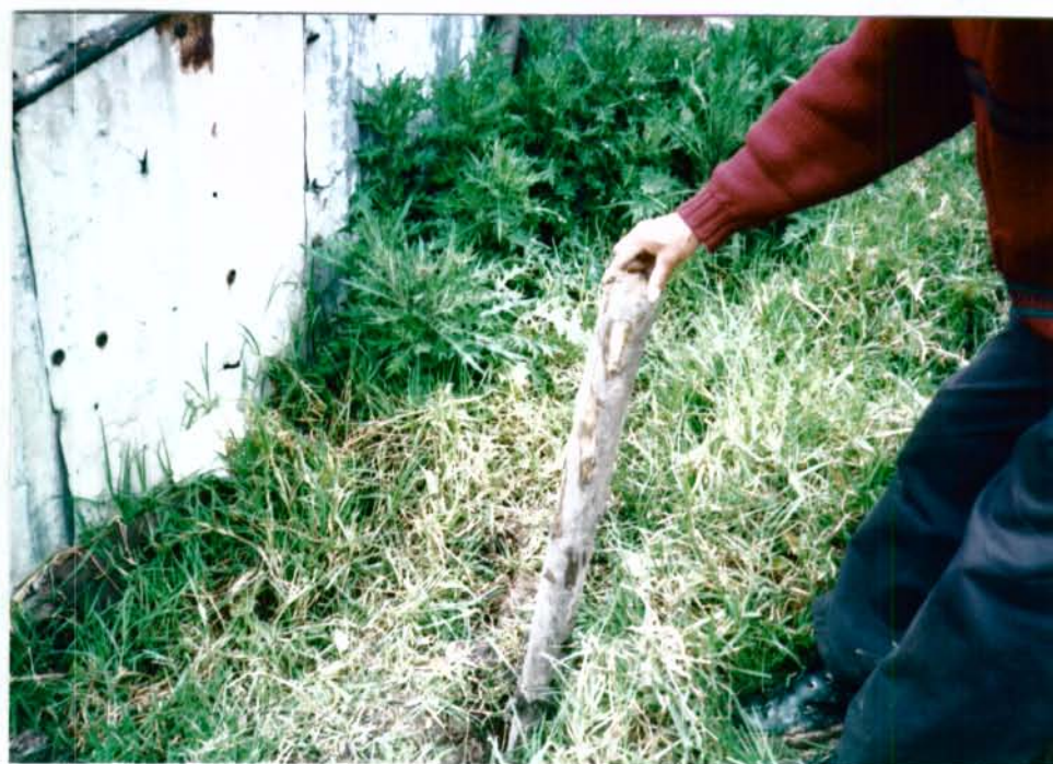
Transversal 7A No. 4-43 Sur Propietario: Tomas Emilio Montero (Promesa de Compra-Venta) Se observo en la parte superior de la vivienda un agrietamiento debido a un desprendimiento del talud, el material reposa en la vivienda.
