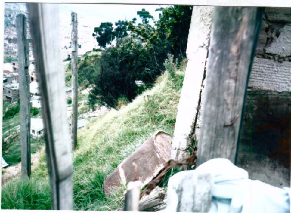
Cra 7A No. 2-74 Sur. Propietario: Pedro Julio Ruiz La vivienda presenta daños en muros y pisos, al parecer por causas de un flujo lento o reptamiento.
