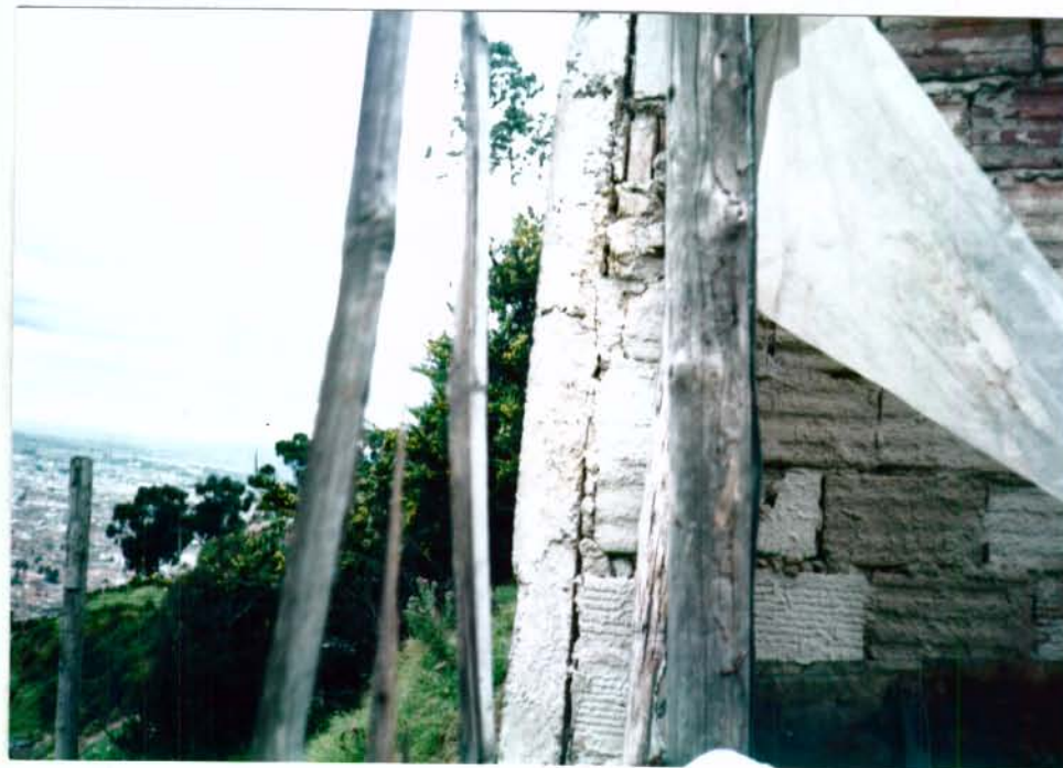
Se observan problemas en la cubierta de la vivienda generando inundación cuando llueve.
