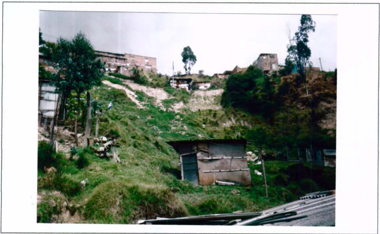
FOTO No. 15. Vista al SE, a la corona del derrumbe reciente del derrumbe del muro. Foto EPR – Sept/99. Cuadro No. 4. Rollo 8688
