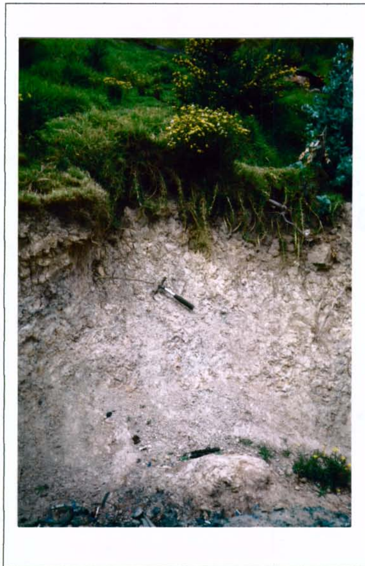
FOTO No. 2. Corte en patio de vivienda en la zona norte del Derrumbe principal. Se observa suelo orgánico y residual Arcilloso con espesor mayor a 1.40 metros. Foto EPR – Sept/99, Cuadro 10, Rollo 8688.
