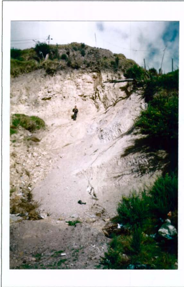
FOTO No. 7. Vista al SEE, en sitio de excavación para minería. Arriba aflora arenisca fracturada; abajo, arcillolita. Al techo suelo Residual y orgánico. Sitio: en EPR – 6. Foto EPR – Sept/99. Cuadro 14, rollo 8692
