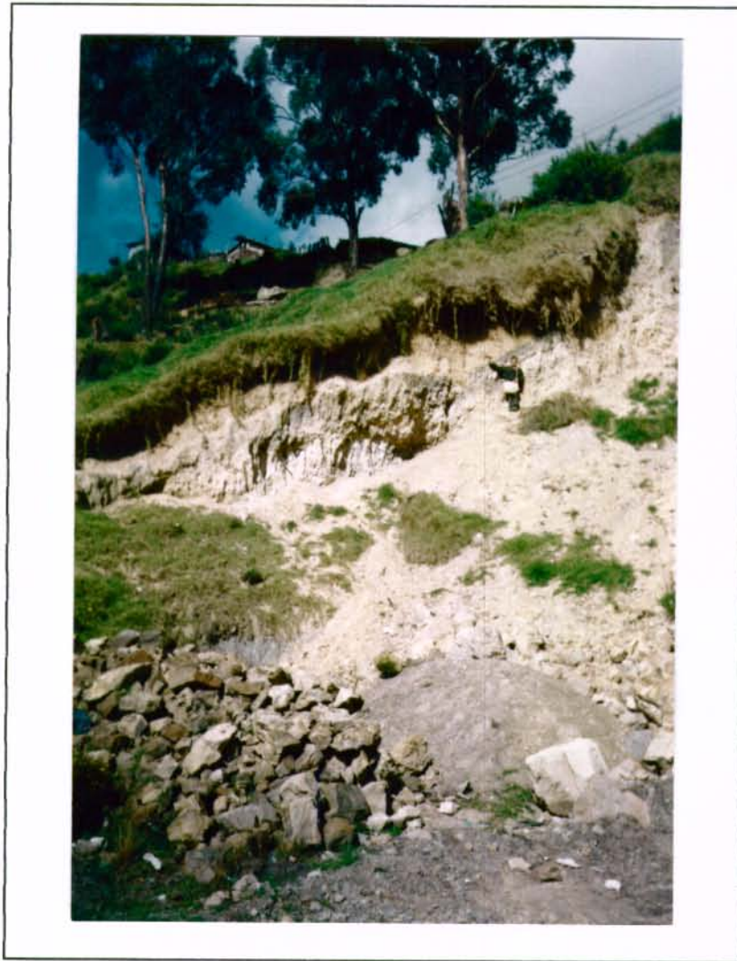
FOTO No. 18. Vista en sitio de EPR-6 hacia la zona del Bosque Borracho. Se observa depósito mixto, colapsado Fallado. En el movimiento se integran depósitos clásticos Recientes y suelos orgánicos y residual. Foto EPR -Sep/99 Cuadro No.13 Rollo 8692
