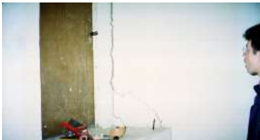
Foto No. 10.17 - CASA 3. DESARROLLO GRIETA 9-9'. FALLA POR TENSIÓN
