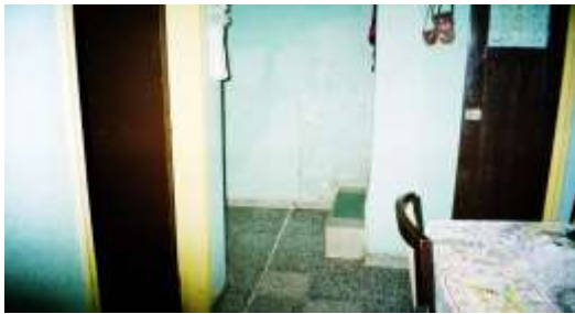
Foto No. 10.16 - CASA 3. DESARROLLO GRIETA 4-4'. FALLA POR TRACCIÓN EN ZONA DE DILATACIÓN
