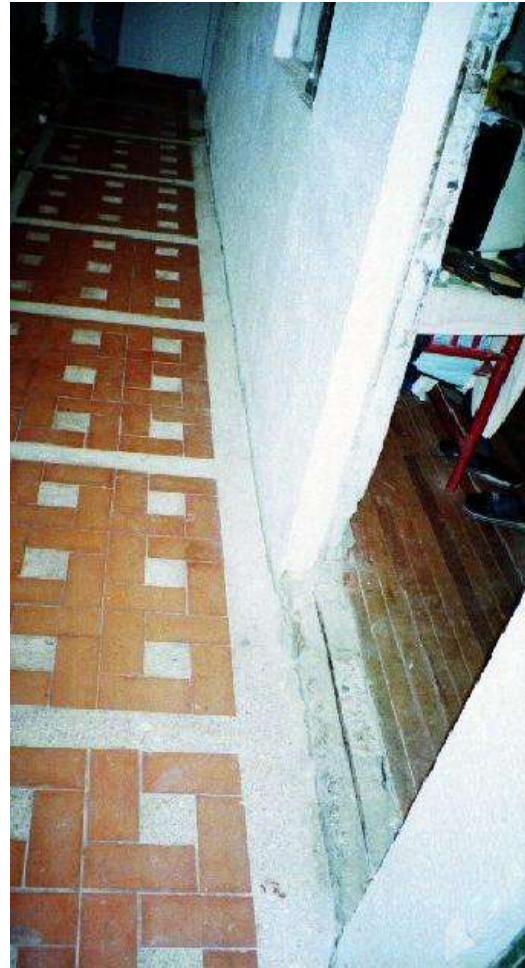
Foto No. 10.19 - CASA 3. DESARROLLO GRIETA EN SEGUNDO PISO, DILATACIÓN
