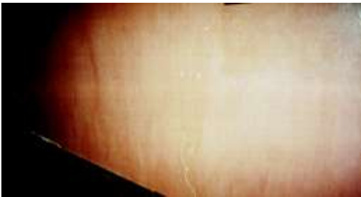
Foto No. 10.7 - CASA 1. DESARROLLO GRIETA 9-9'. FALLA POR TENSIÓN DEBIDO A FLEXIÓN EN EL PLANO DEL MURO
