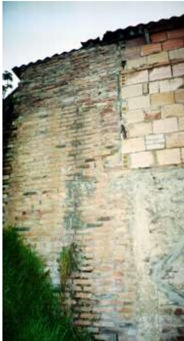
FOTO No. 10.30 - CASA 3. DESARROLLO GRIETA G.5-5, VISTA EXTERNA
