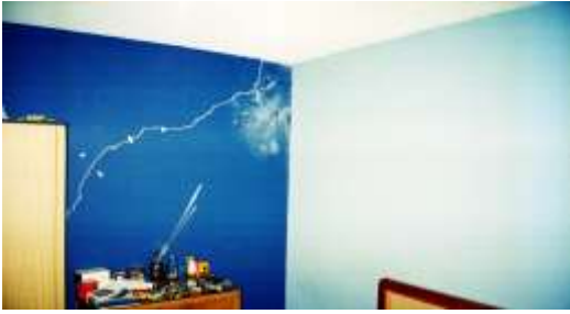
Foto No. 10.6 - CASA 1. DESARROLLO GRIETA 8-8'. FALLA POR TRACCIÓN DIAGONAL
