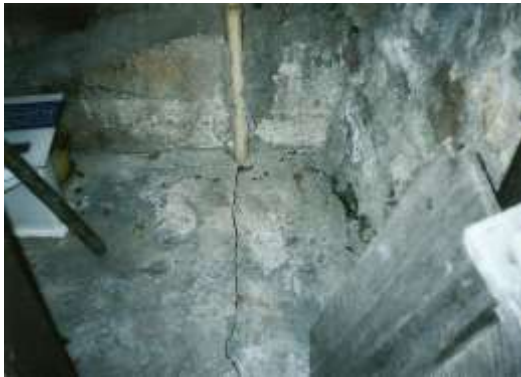
FOTO No. 10.33 - LOTE LINDERO CASA 3. GRIETA INTERNA EN PISO BAÑO
