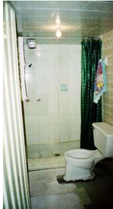
Foto No. 10.14 - CASA 2. DESARROLLO GRIETA G.3-3'. FALLA POR TRACCIÓN DIAGONAL
