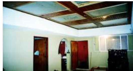
FOTO No. 10.31 - CASA 1. DESARROLLO DE FISURAS EN LA ZONA INTERIOR, VIGA CABEZAL EN EL PATIO CENTRAL.
