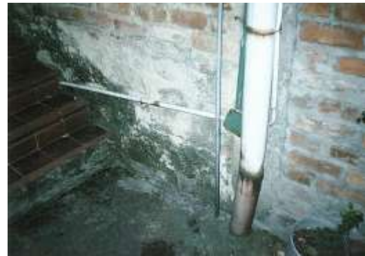
FOTO No. 10.34 - LOTE LINDERO CASA 3. GRIETA EXTERNA EN PISO BAÑO Y ESCALERA DE ACCESO
