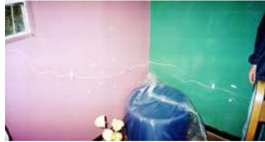
Foto No. 10.13 - CASA 2. DESARROLLO GRIETA 2-2 Y 7-7'. FALLA POR TENSIÓN AXIAL DEBIDO A PÉRDIDA DE SOPORTE EN LA BASE DEL MURO
