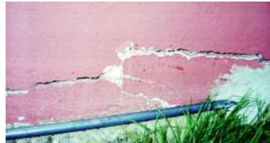
FOTO No. 10.26 - CASA 1. ASENTAMIENTO EN VIGA DE AMARRE
