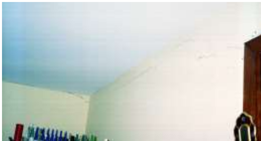
Foto No. 10.18 - CASA 3. DESARROLLO GRIETA HORIZONTAL POR LA PARTE SUPERIOR DEL MURO EN ZONA G.6-6'
