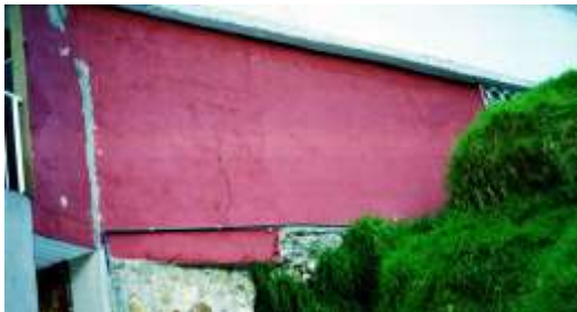
FOTO No. 10.25 - CASA 1. GRIETA 9-9', FACHADA LATERAL IZQUIERDA, VISTA EXTERIOR
