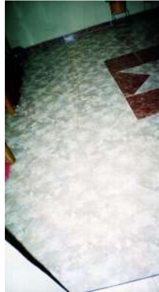
Foto No. 10.10 - CASA 1. DESARROLLO DE GRIETA G.PATIO EN EL PISO ZONA DE PATIO CENTRAL. FALLA POR TENSIÓN AXIAL
