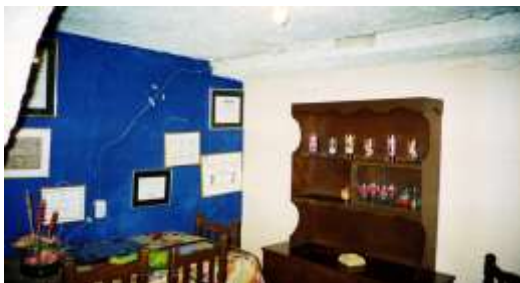
Foto No. 10.12 - CASA 2. DESARROLLO GRIETA 1-1'. FALLA POR TRACCIÓN DIAGONAL
