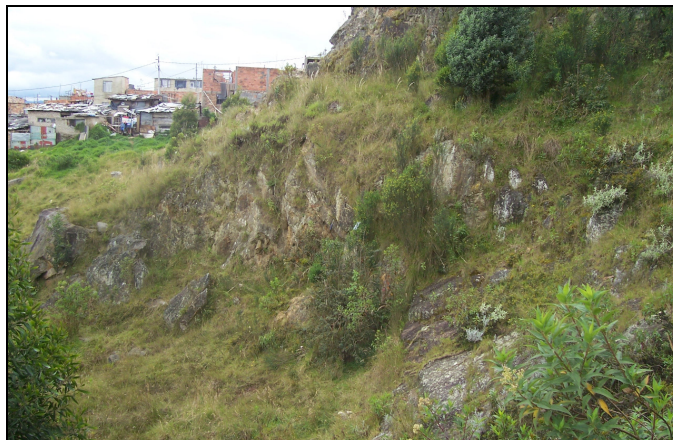
Foto 3.23 . TALUDES DE EXTRACCIÓN EN ZONAS DE BRECHA TECTÓNICA; EN GENERAL ESTAS FORMAS SON ESTABLES. PARTE BAJA NORTE DEL FRENTE SUPERIOR.
