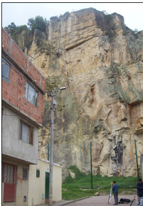
Foto 3.27 TALUD CON POSIBILIDAD CINEMÁTICA DE CAÍDA DE BLOQUES. PARA IDEA DE LA ESCALA, NÓTESE EL TAMAÑO DE LA PERSONA ENCERRADA EN EL ÓVALO
