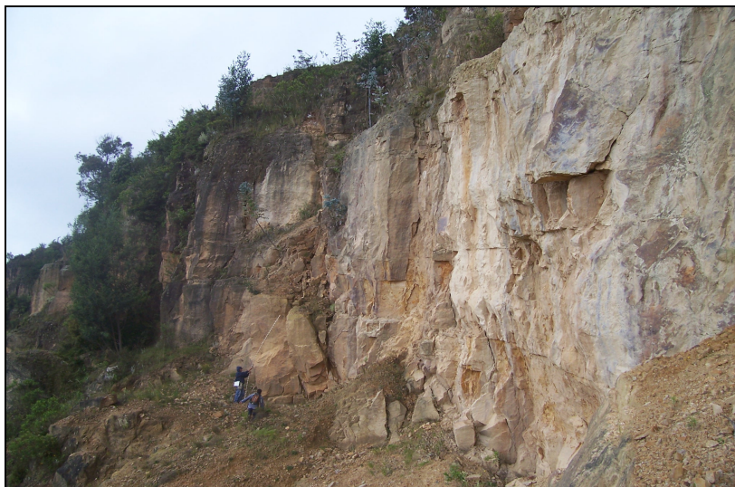
Foto 3.22 TALUDES DE EXTRACCIÓN EN MACIZOS ROCOSOS MODERADAMENTE A BIEN CEMENTADOS. NÓTENSE LA PENDIENTE DEL TALUD Y SU ALTURA, ADEMÁS DE LA SUSCEPTIBILIDAD A PRESENTAR CAÍDA DE BLOQUES. PARTE ALTA – CENTRAL DEL FRENTE SUPERIOR
