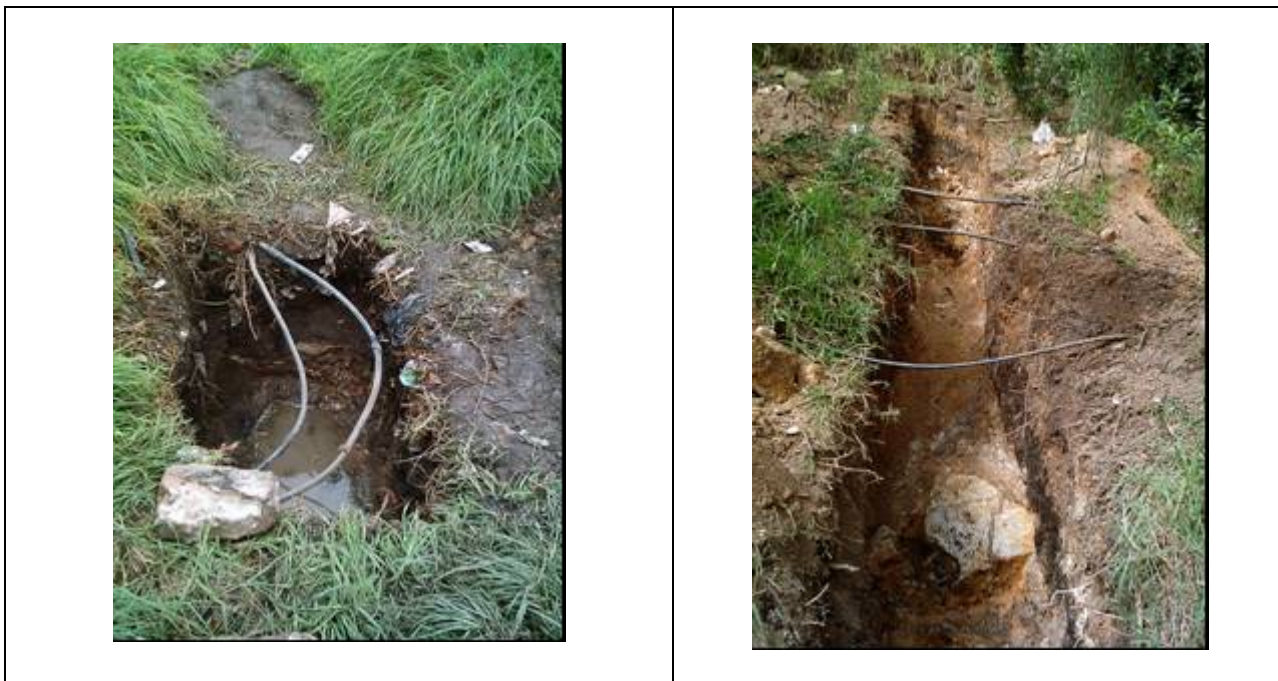
Foto 1. Acueducto con mangueras existente en el barrio
