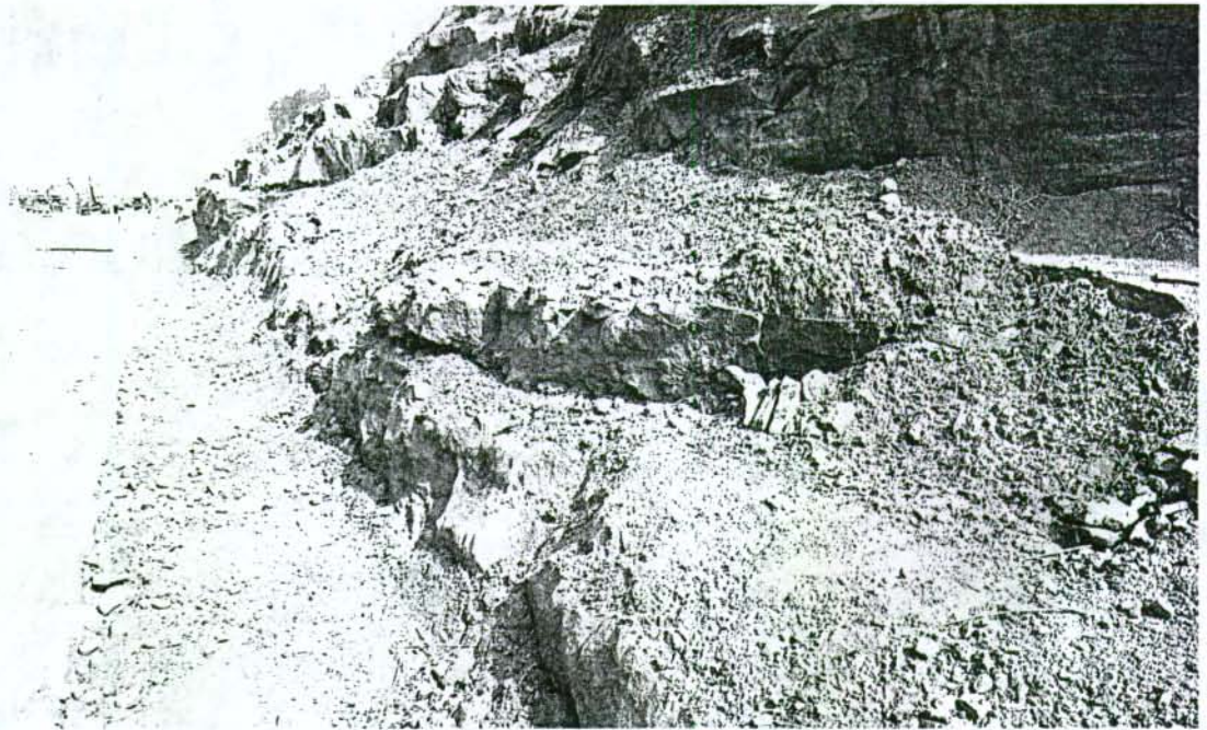
Talud escarpado en la nueva línea ferroviaria de alta velocidad (cerca de Würzburg), antes del tratamiento
