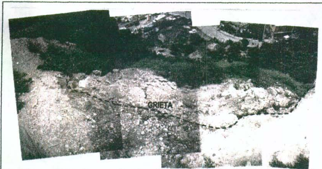
Foto 3.11a Grieta de coronación del posible deslizamiento en la zona norte sector I-A-5 r -b 1 (vista frontal)
