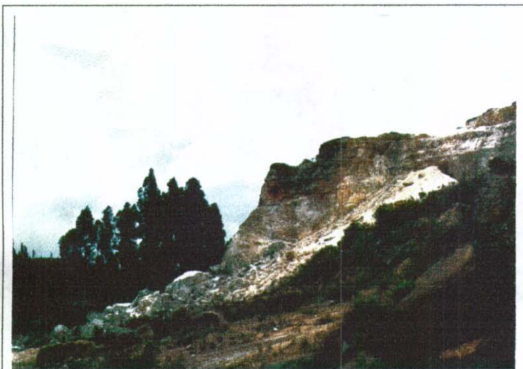
Foto. 3.1 Relieve estructural donde se evidencia la caída de rocas al norte del barrio Soratama. La pendiente estructural da lugar a deslizamientos de tipo traslacional.
