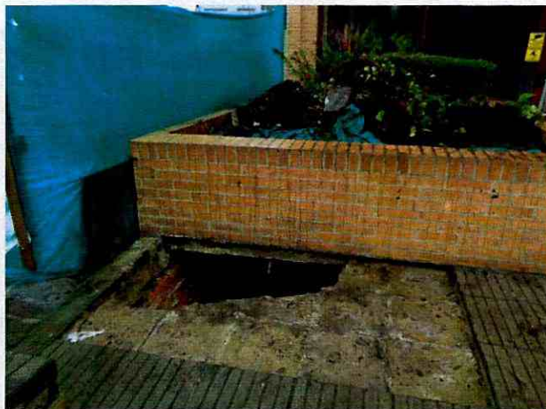
Fotografía 3. Hundimiento en el terreno de en la materia y sendero peatonal hacia el costado norte del edificio Spacio
