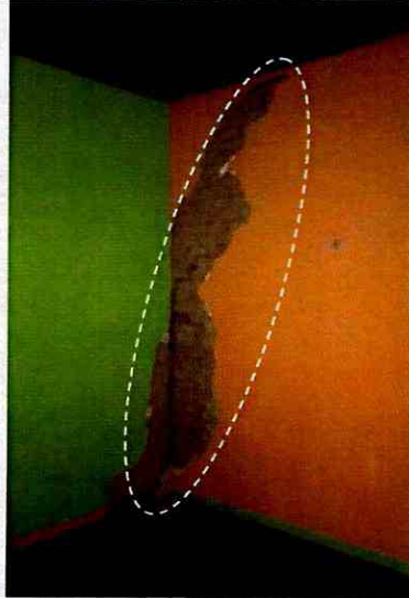
Fotografía 8. Fisuras y grietas identificadas en muros del costado suroriental de la edificación localizada en el predio de la Carrera 7 No. 7 – 22/24 Sur.
