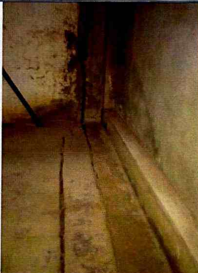
Fotografía 10. Aberturas en pisos del costado suroriental de la edificación localizada en el predio de la Carrera 7 No. 7 – 22/24 Sur. Se observa la pérdida de verticalidad.
