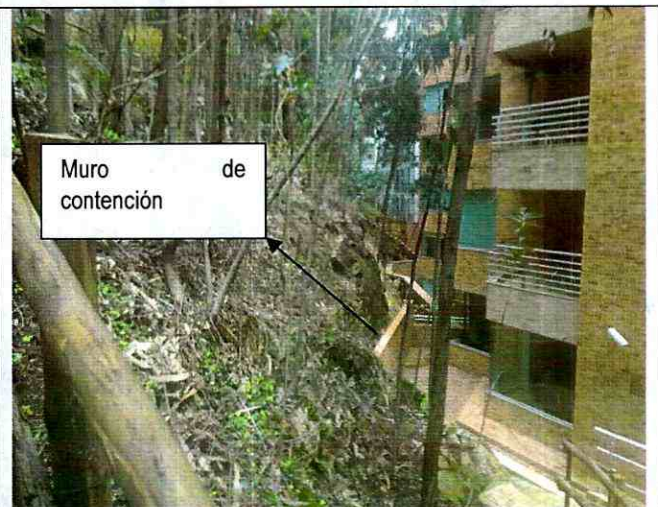
Foto 2. Vista del talud rocoso ubicado al costado sur-oriental del Conjunto Residencial Balcones de Medina.
