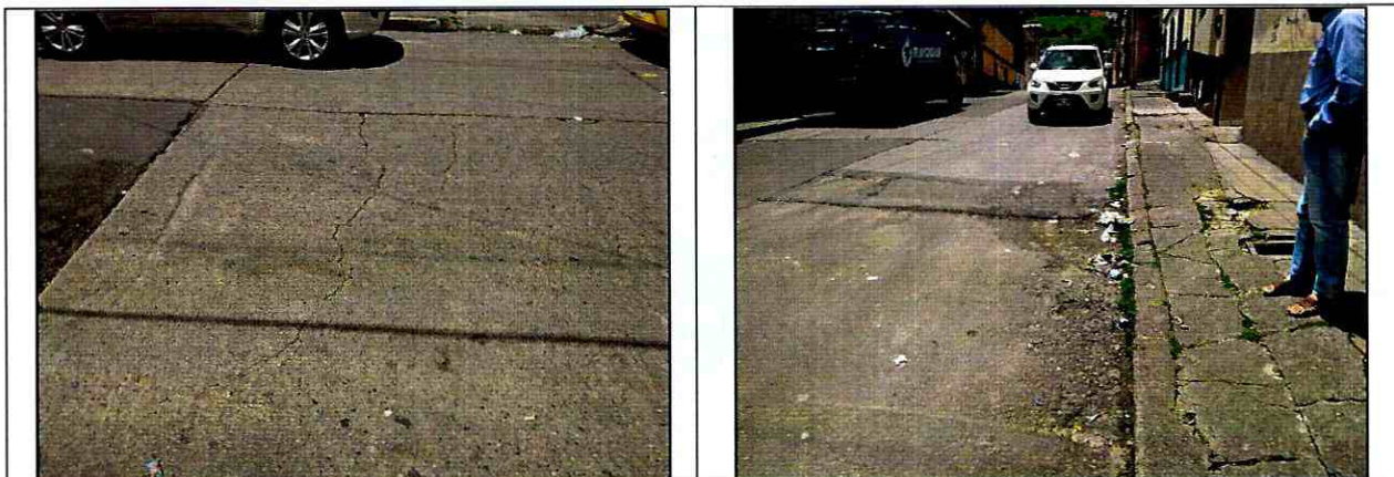
Fotos 3 y 4. Vista del tramo vial evaluado en el que se aprecian algunos daños que no compromete la funcionalidad del mismo.
