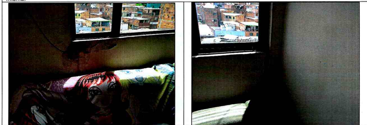
Fotos 7 y 8. Vista al interior del predio de la Calle 2 Bis No. 1A-19 y los daños que se presentan.
