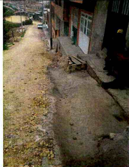
Fotografía 6. Zanjas con recubrimiento en mortero como medida para conducir aguas de escorrentía superficial con el propósito de evitar en ingreso a algunas viviendas del sector.
