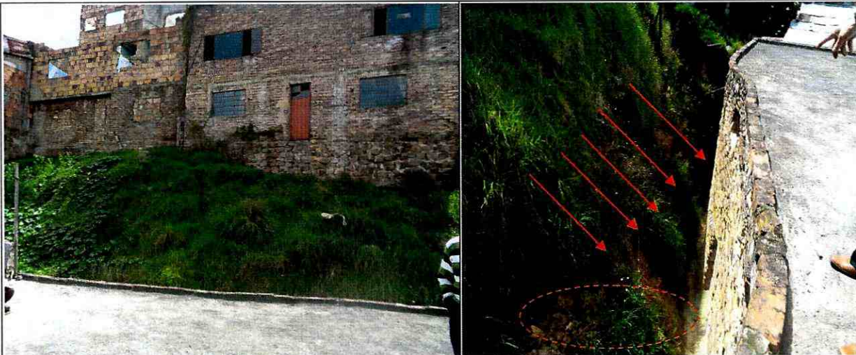
Fotografías 3 y 4. Desprendimientos menores de material de volumen cercano a los 0,5 m 3 los cuales se depositan en la parte baja y se recuestan sobre el muro de cerramiento de la vivienda.
