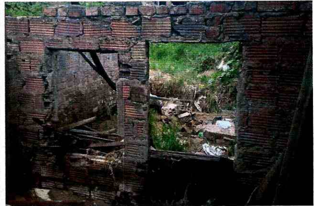
Fotografía 4. Cerramientos abandonados y ubicados al costado oriental de la vivienda inspeccionada.
