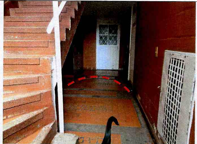
Foto 3: Vista del levantamiento del recubrimiento de enchape de la placa de piso del acceso a la torres 15
