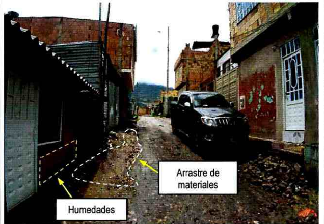
Fotografía 8. Evidencia de humedades y arrastre de materiales en algunos sectores de la zona inspeccionada en el Barrio La Orquídea del Sur II Sector de la Localidad Usme.
