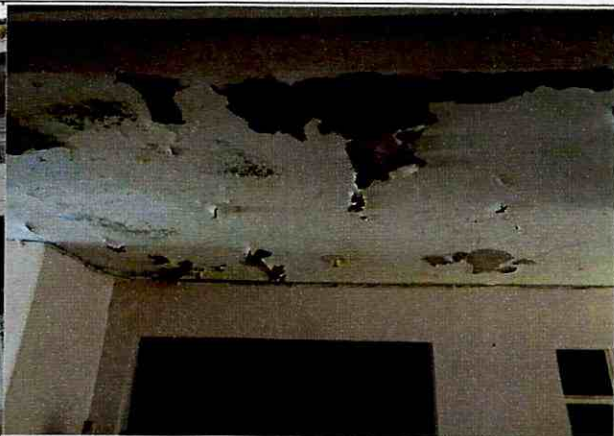
Fotografía 2. Se observan daños como fisuras en los muros de cerramiento y humedades al interior del predio.
