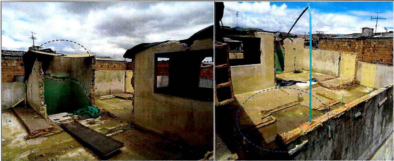
Fotografías 4 y 5. Actividades de demolición que se están realizando en el sector de la terraza sin ningún tipo de protección ante las aguas lluvias está generando deterioro de los elementos estructurales y no estructurales de la vivienda.
