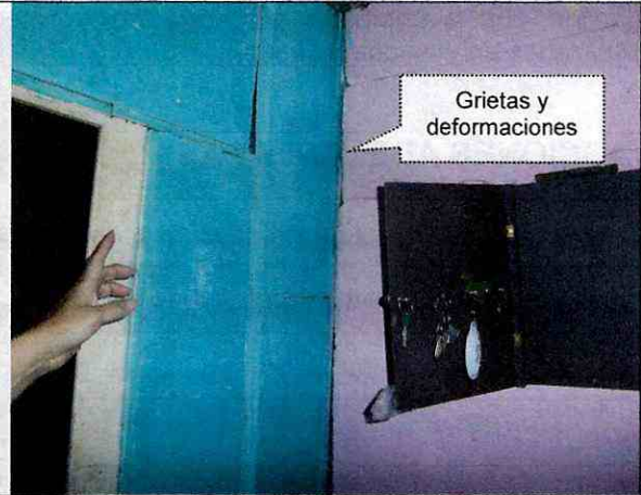
Fotografía 4. Vista interna de vivienda en P1, se observan grietas y deformaciones múltiples en paredes.
