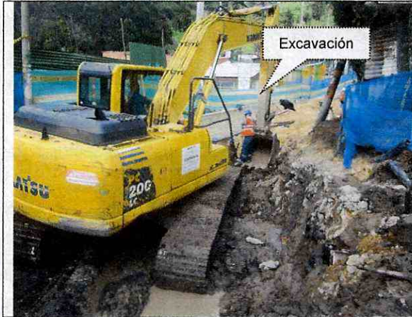
Fotografía 3. Vista de actividades de excavación próximas a P1 y P2 (imagen tomada el 26/Marzo/2018).
