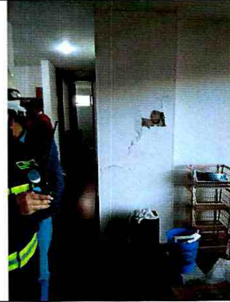
Fotografía 2. Vista de espacio interior del Apartamento 704, se observa la presencia de grietas en muro no estructural.
