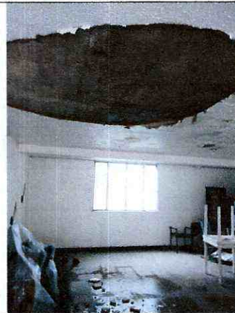
Fotografía 2. Vista de espacio interior (Oficina JAC), donde se presentó desprendimiento de cielo raso.
