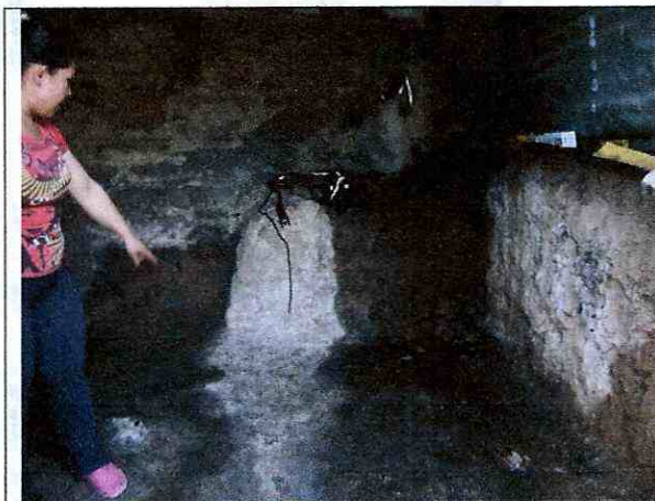
Fotografía 3. Vista de talud de corte en la vivienda visitada, se observan filtraciones.
