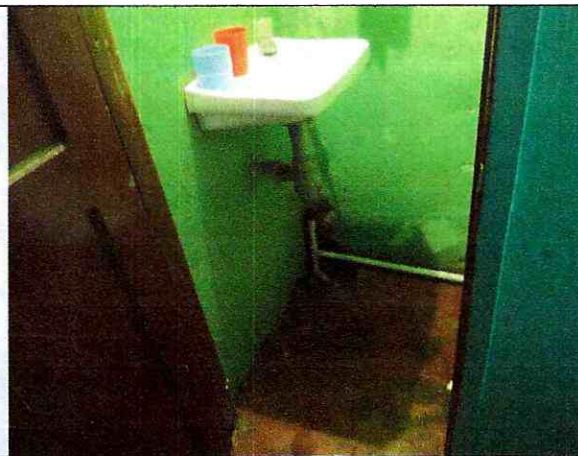
Fotografía 4. Vista interna de espacio interior de la vivienda visitada, se observa humedad en paredes.
