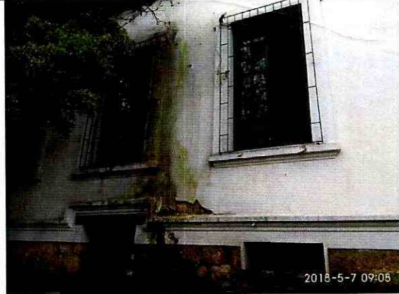
Fotografía 4. Se observan los daños del predio de la Calle 119 N° 6-40 y Calle 119B N° 6-51, de la Localidad de Usaquén, (construcción costado nor-occidental)
