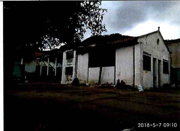
Fotografía 6. Se observan los daños del predio de la Calle 119 N° 6-40 y Calle 119B N° 6-51, de la Localidad de Usaquén, (construcción costado sur)
