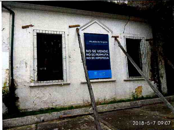
Fotografía 3. Se observan los daños del predio de la Calle 119 N° 6-40 y Calle 119B N° 6-51, de la Localidad de Usaquén, (construcción costado nor-oriental)
