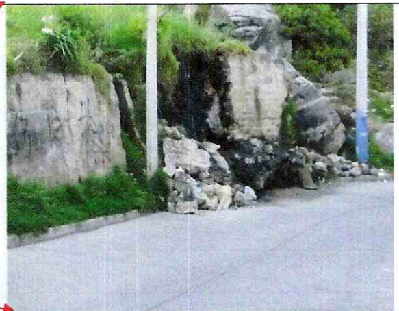
Fotografía 2. Vista en detalle del talud de corte en el punto donde se presentó movimiento en masa del talud.
