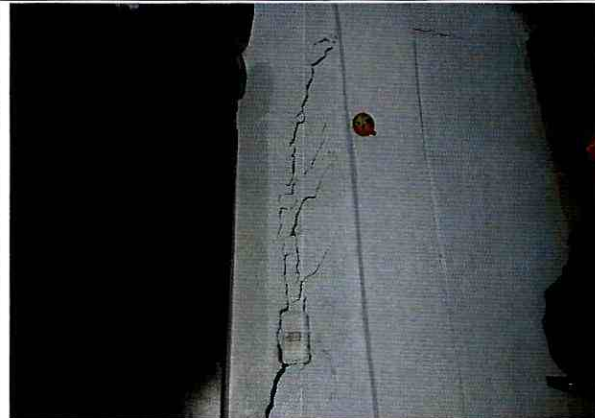
Foto No. 6. Condiciones muro divisorio Predio 2. Fotografía tomada el 17/04/2018
