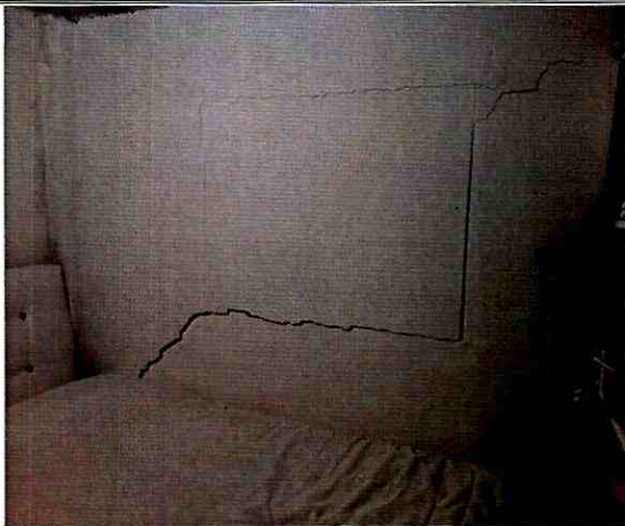
Foto No. 3. Condiciones muro divisorio predio 2. Tomada de DI-10849 – 22/05/2017
