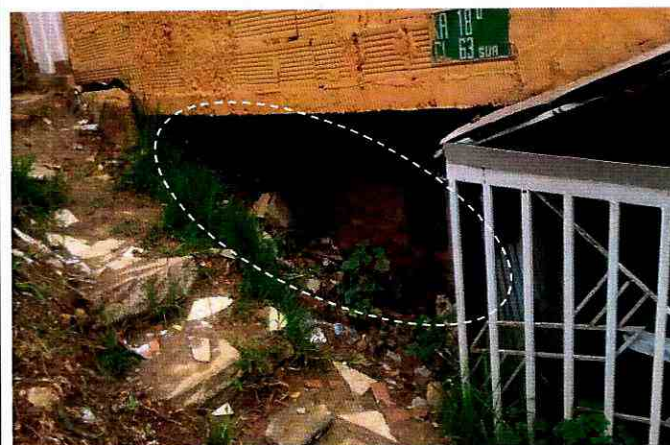
Fotografía 3. Humedades en cerramientos que son colindantes con el terreno del tramo vehicular de la Carrera 18 R entre la Calle 63 y la Calle 63 A.
