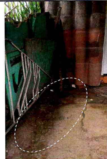
Fotografía 4. Humedades en cerramientos que son colindantes con el terreno del tramo vehicular de la Carrera 18 R entre la Calle 63 y la Calle 63 A.
