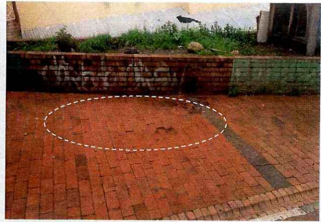
Fotografía 6. Leve hundimiento del adoquín que conforma andén peatonal del costado oriental de la materia ubicada a la altura de la Carrera 8 Este, entre la Calle 1 B Bis y la Calle 1 C.
