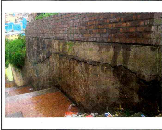
Fotografía 3. Grietas en muro del costado occidental de la de la materia ubicada a la altura de la Carrera 8 Este, entre la Calle 1 B Bis y la Calle 1 C.
