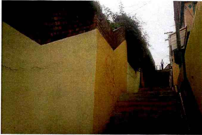
Fotografía 5. Fisuras y grietas en muro del costado occidental de la de la materia ubicada a la altura de la Carrera 8 Este, entre la Calle 1 B Bis y la Calle 1 C.
