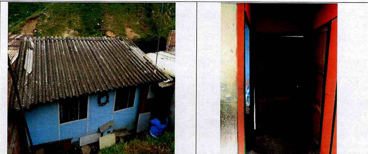
Fotografías 3 y 4. Predio de la Carrera 44 No 74A-37 Sur del barrio Jerusalén Potosí de la Localidad de Ciudad Bolívar.
