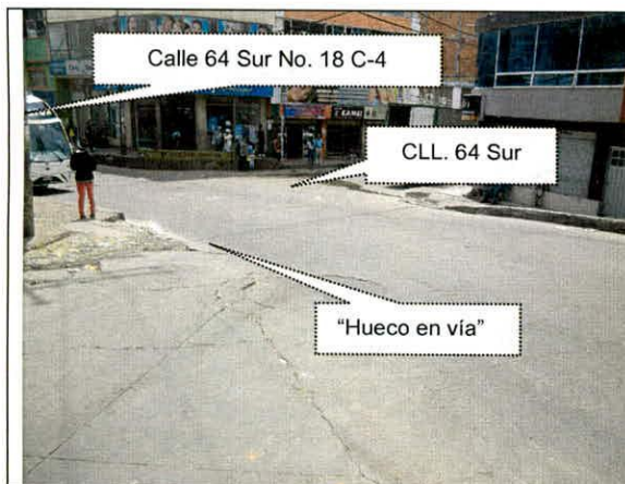
Fotografía 1. Vista de daño en la vía, frente al predio de la Calle 64 Sur No. 18 C-4.
