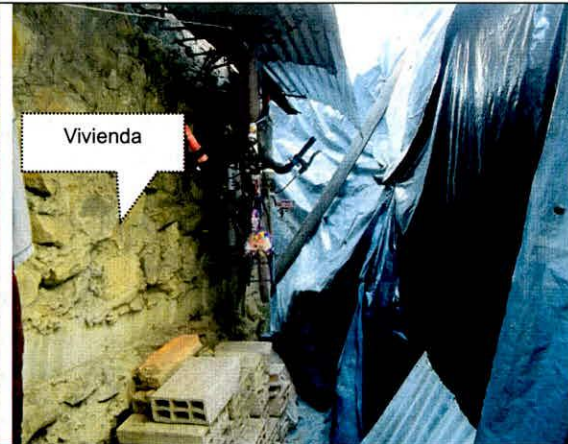
Fotografía 4. Vista del primer nivel de la vivienda, contiguo al talud de corte, recubierto con plástico.
