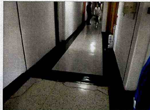
Fotografía 4 – Vista de Junta constructiva en piso del 4 nivel, se observan fisuras en piso, imagen tomada el 26 de Marzo de 2018.
