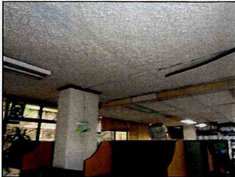
Fotografía 3 – Vista de Junta constructiva en columna y placa de entrepiso, en zona de tercer nivel, imagen tomada el 14 de Noviembre de 2017.
