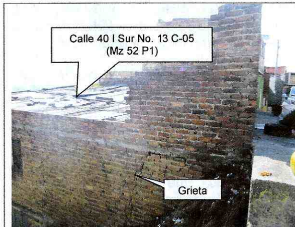
Foto 3. Muro del costado sur del predio de la Calle 40 I Sur No. 13 C-05, se observa grieta de tendencia diagonal.
