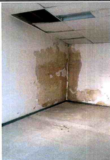
Fotografía 5. Deterioro en muros de la edificación ubicada en el predio de la Calle 64 No. 121 – 60, en el Sector Catastral Engativá Zona Urbana de la Localidad Engativá.
