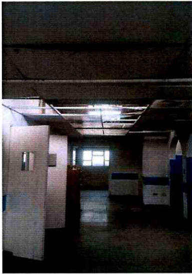
Fotografía 11. Pérdida de plaquetas que conforman el cielo raso de la edificación ubicada en el predio de la Calle 64 No. 121 – 60, en el Sector Catastral Engativá Zona Urbana de la Localidad Engativá.
