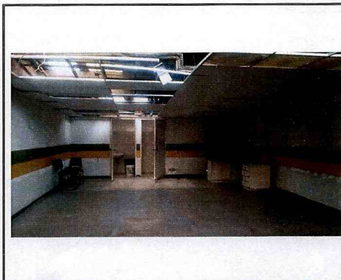
Fotografía 9. Pérdida de plaquetas que conforman el cielo raso de la edificación ubicada en el predio de la Calle 64 No. 121 – 60, en el Sector Catastral Engativá Zona Urbana de la Localidad Engativá.
