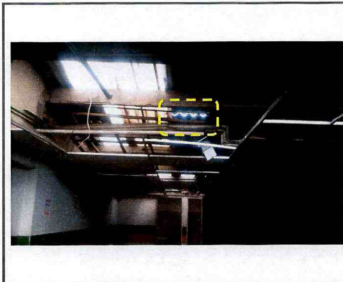
Fotografía 7. Desajustes y roturas en la cubierta de la edificación ubicada en el predio de la Calle 64 No. 121 – 60, en el Sector Catastral Engativá Zona Urbana de la Localidad Engativá.
