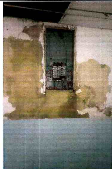
Fotografía 6. Deterioro en muros de la edificación ubicada en el predio de la Calle 64 No. 121 – 60, en el Sector Catastral Engativá Zona Urbana de la Localidad Engativá.
