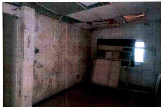
Fotografía 4. Deterioro en muros y cielo raso de la edificación ubicada en el predio de la Calle 64 No. 121 – 60, en el Sector Catastral Engativá Zona Urbana de la Localidad Engativá.
