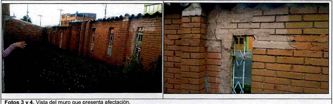
Fotos 3 y 4. Vista del muro que presenta afectación.
