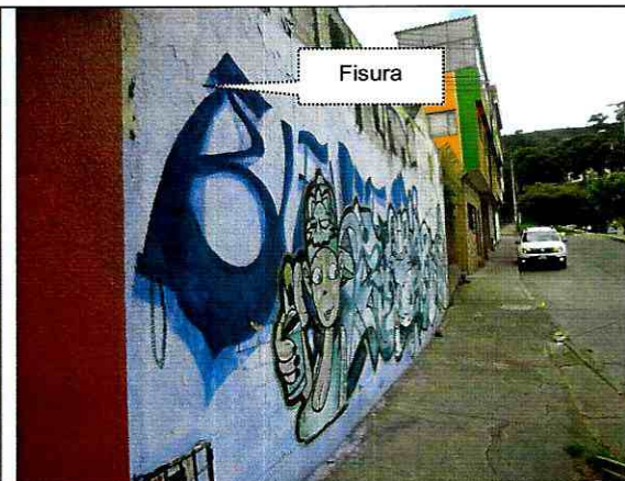
Fotografía 4. Vista de muro en la Calle 35 A Sur No. 4 A-94 con daños por presencia de grietas.
