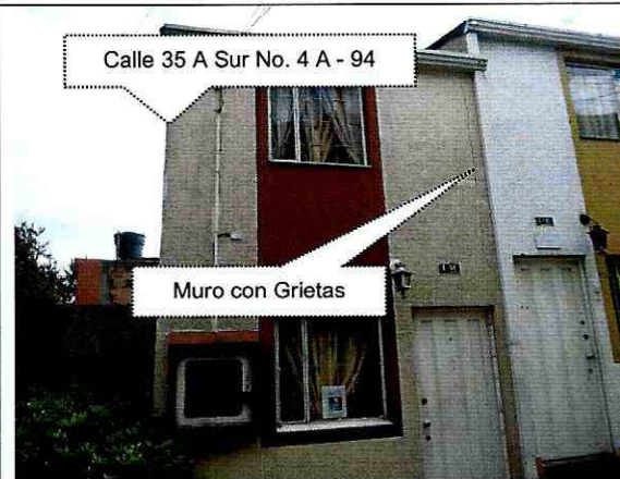
Fotografía 2. Vista de la fachada del predio de la Calle 35 A Sur No. 4 A - 94, se observa grieta vertical en muro de fachada.
