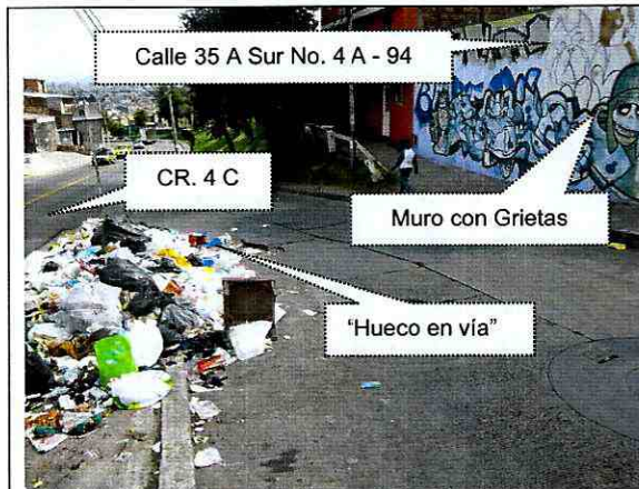
Fotografía 1. Vista de muro en la Calle 35 A Sur No. 4 A-94 con daños por presencia de grietas y vista de daño sobre la vía.
