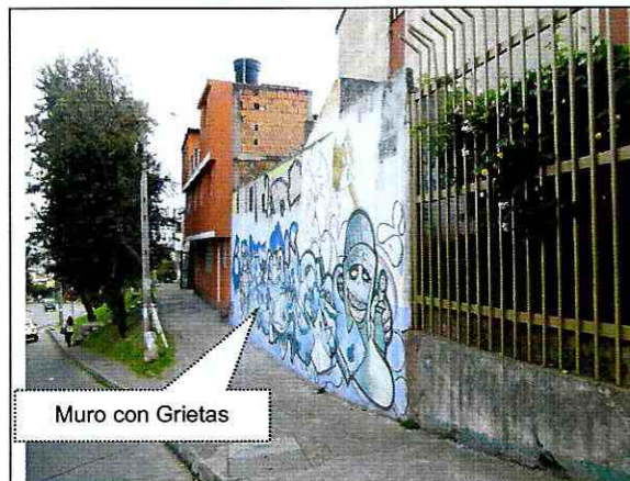
Fotografía 3. Vista de muro en la Calle 35 A Sur No. 4 A-94 con daños por presencia de grietas.
