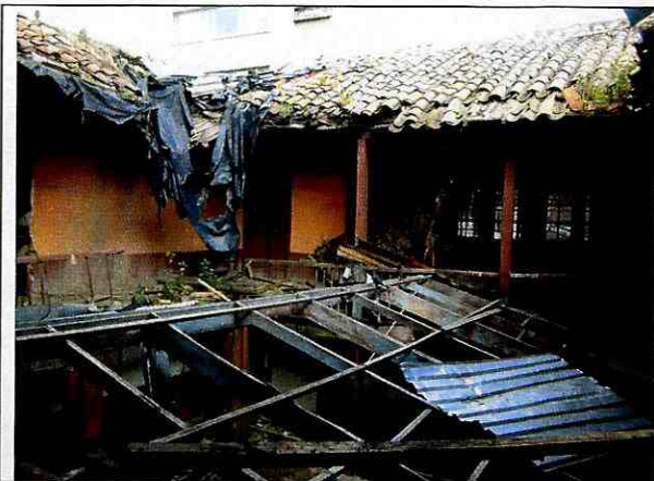
Fotografía 3. Daños en la cubierta costado oriental de la edificación del predio de la Calle 16 No. 7 - 78.
