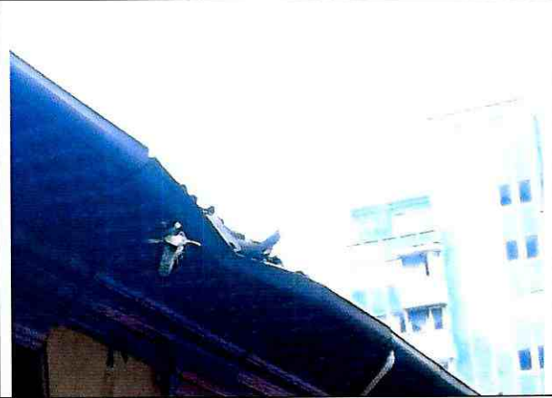
Fotografía 6. Elementos de cubierta (Tejas), con riesgo de caídas en la edificación de la Calle 16 No. 7 – 78.
