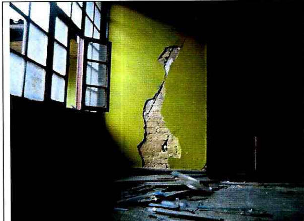
Fotografía 5. Grieta en muro del costado occidental en el segundo nivel de la edificación de la Calle 16 No. 7 – 78.
