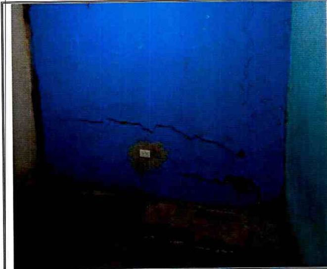
Fotografía 3. Grietas en muros de las dos habitaciones del costado noroccidental de la vivienda ubicada en el predio de la Calle 111 A Bis Sur No. 4 – 36, en el Barrio Villa Alemania de la Localidad Usme.
