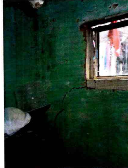
Fotografía 4. Grietas en muros de las dos habitaciones del costado noroccidental de la vivienda ubicada en el predio de la Calle 111 A Bis Sur No. 4 – 36, en el Barrio Villa Alemania de la Localidad Usme.
