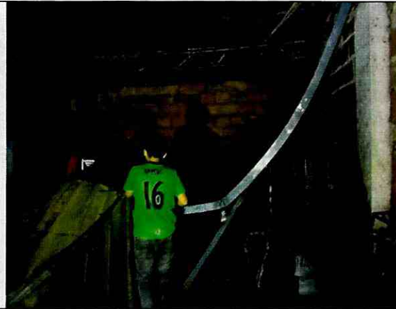
Fotografía 4. Vista de la zona posterior del segundo nivel (costado norte) donde se observa cubierta parcialmente colapsada.
