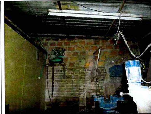
Fotografía 7. Vista de muro perimetral de primer nivel en el predio de la Tv. 80 B No. 65 F – 40 Sur, no se observan daños.
