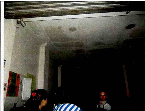
Fotografía 5. Vista de espacio interior del primer nivel, de la edificación donde se presentó el incendio, no se observan daños estructurales importantes.
