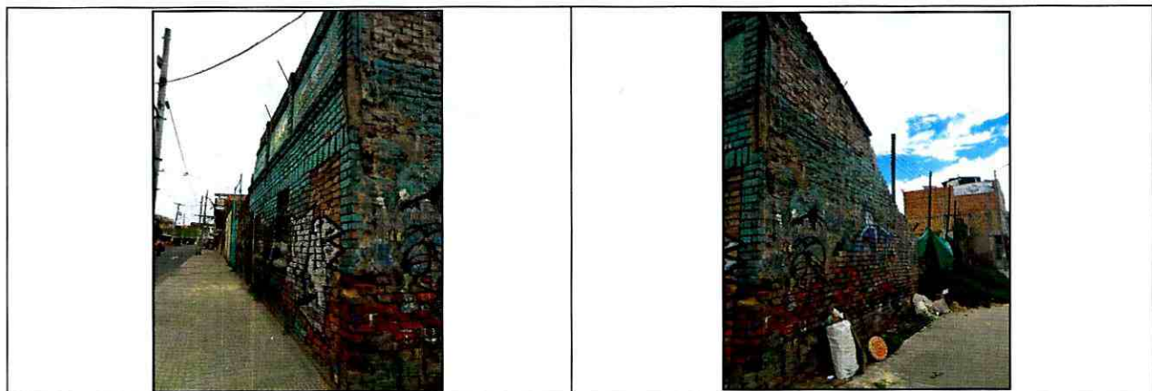
Fotos 3 y 4. Vista del muro que presenta afectación.
