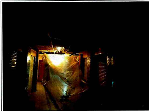
Foto 5. Vista de los daños observados en el cielo raso del último nivel.
