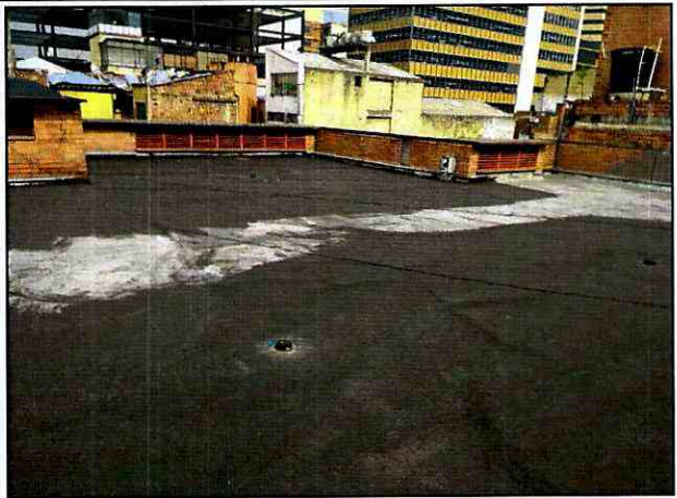
Foto 6. Vista del estado del manto de impermeabilización, en el que se evidencia falta de mantenimiento.
