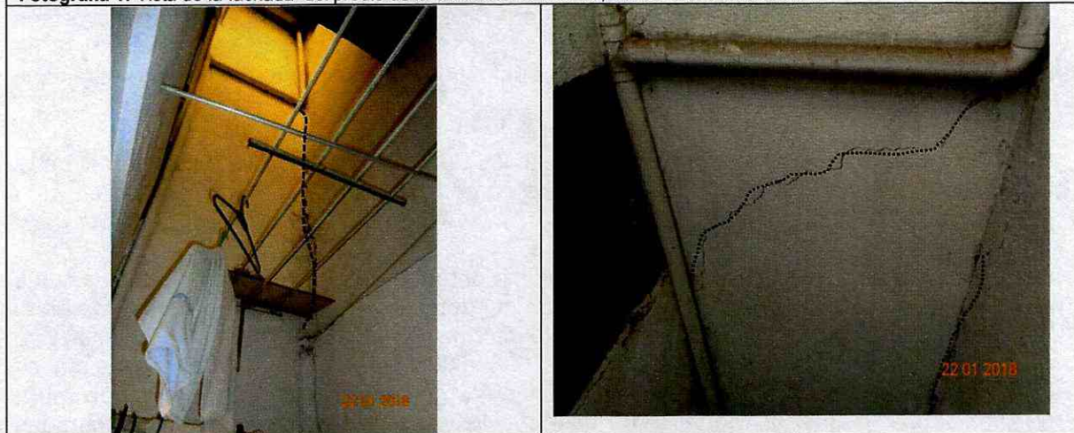
Fotografía 2 y 3: Se evidencian las fisuras en los muros perimetrales, e igualmente la separación entre la cubierta y los muros que lo soportan.
