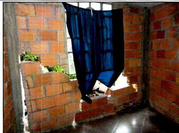
Foto 4. Vista de los daños producto del movimiento en masa evaluado.
