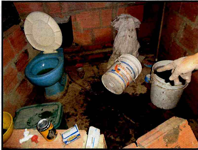
Fotografía 7. Vista al interior de la vivienda emplazada en el Lote 17 de la Manzana 24, la cual presentó afectación.
