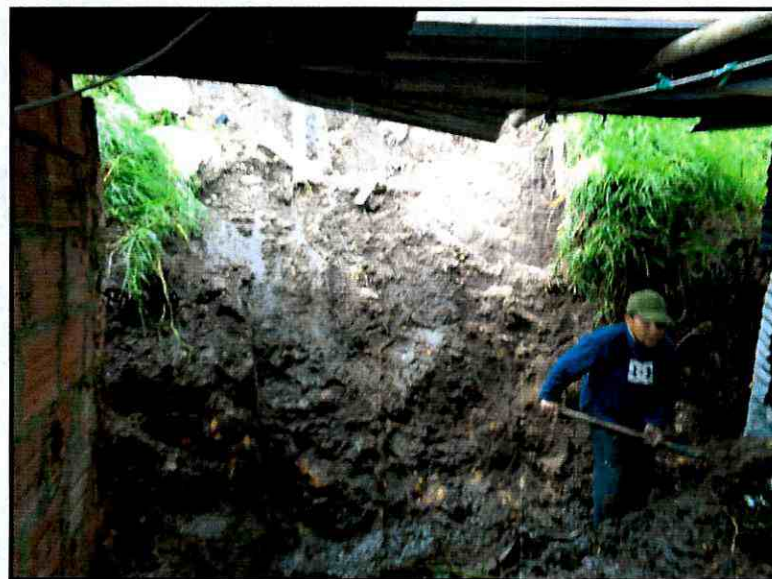
Fotografía 6. Vista al interior de la vivienda emplazada en el Lote 17 de la Manzana 24, la cual presentó afectación.
