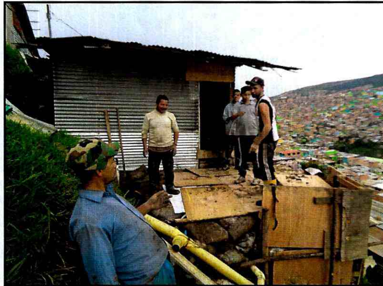
Fotografía 5. Vista de la vivienda emplazada en el Lote 17 de la Manzana 24, la cual presentó afectación.
