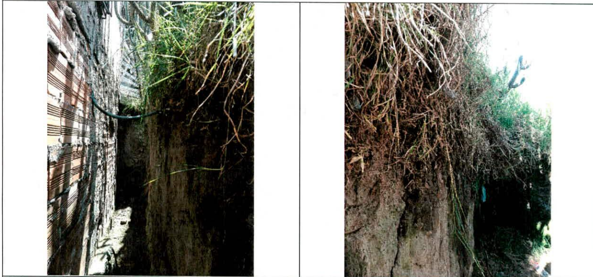
Fotografía 3 y Fotografía 4. Vista del talud de corte de la parte frontal del predio de la Carrera 18 D No. 81 C-10 Sur en el el Sector Catastral Quiba Urbano de la Localidad de Ciudad Bolívar
