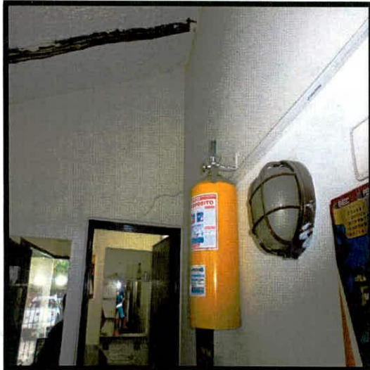
Fotografía 5. Estado de las fisuras evidenciadas al interior de la portería el día 3 de Mayo de 2017
