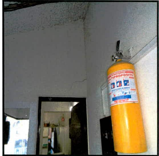
Fotografía 6. Estado de las fisuras evidenciadas al interior de la portería el día 21 de Mayo de 2017
