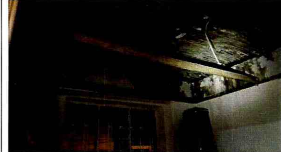
Fotografía 2. Colapso de cielo raso en drywall en un cuarto de la Carrera 15 A No. 64 - 17 en el Sector Catastral La Esperanza de la Localidad de Barrios Unidos.
