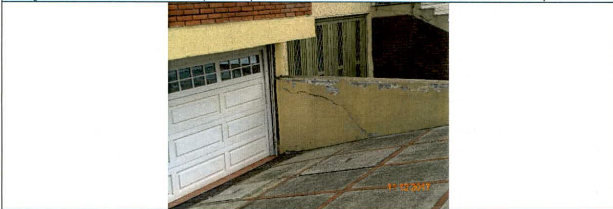
Fotografía 2: Vista del muro perimetral de acceso a la edificación del predio emplazado en la Calle 53 N° 37 A - 66 de la Localidad de Teusaquillo.
