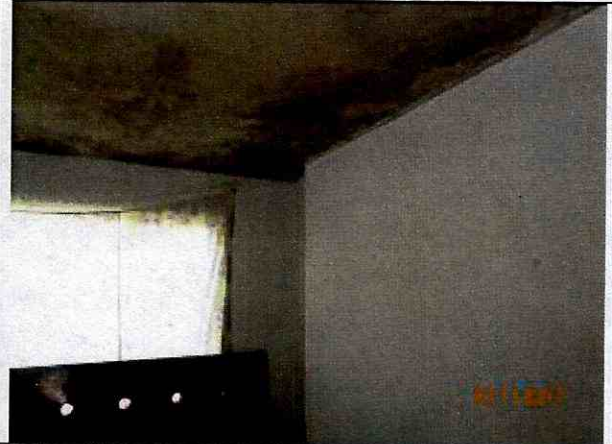
Fotografía 12. Humedades en el segundo nivel de la vivienda de la Diagonal 100B Sur 6-42 Este, en el Barrio Nuevo Porvenir de la Localidad de Usme.
