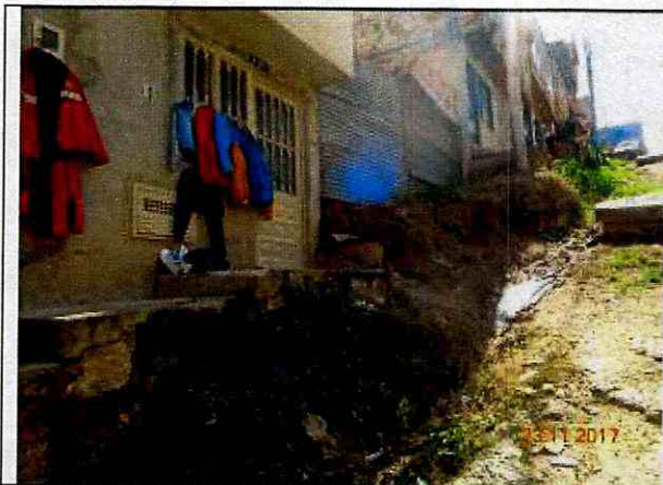
Fotografía 5. Andenes de la vivienda de la Diagonal 100B Sur 6-42 Este, en el Barrio Nuevo Porvenir de la Localidad de Usme.
