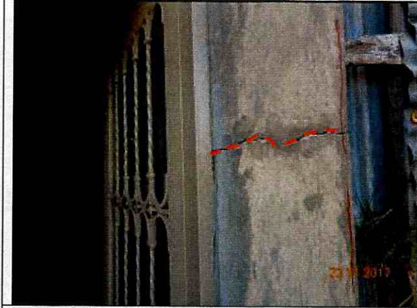
Fotografía 11. Fisura transversal en la entrada del primer nivel de la vivienda de la Diagonal 100B Sur 6-42 Este, en el Barrio Nuevo Porvenir de la Localidad de Usme.
