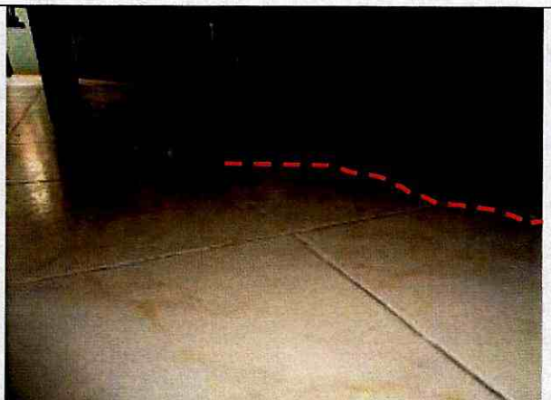
Fotografía 2. Fisuras diagonales en los pisos en el primer nivel del predio de la Calle 49 D Bis Sur No. 5U-25, en el Sector Catastral Molinos del Surde la Localidad de Rafael Uribe Uribe
