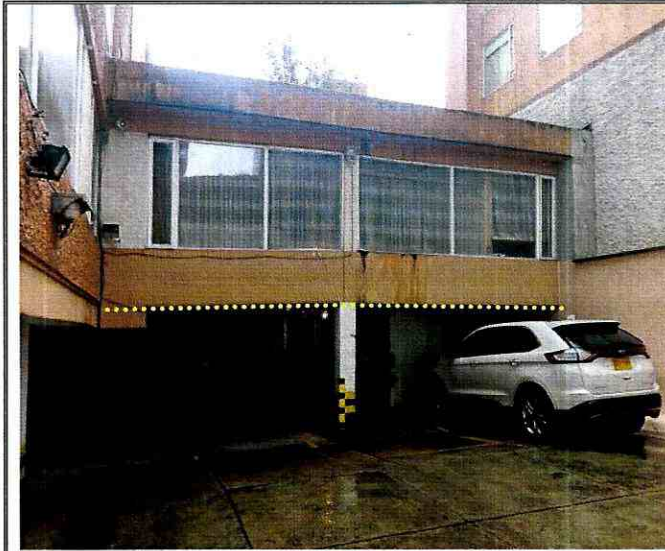
Fotografía 3. Edificación del costado norte del edificio Sonsoles ubicado en el predio de la Carrera 14 No. 92 – 16, en el Sector Catastral Chico Norte de la Localidad Chapinero. Se observa el sótano de estacionamiento y la pérdida de horizontalidad de la placa de entpiso
