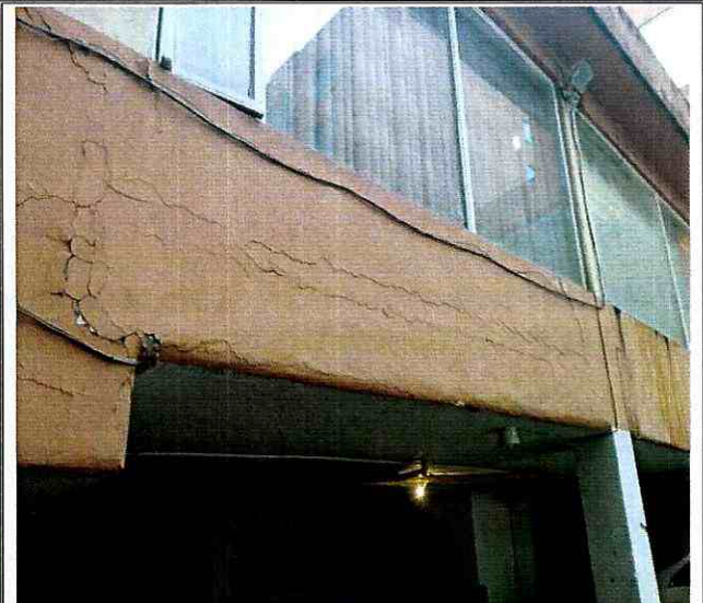
Fotografía 4. Fisuras en muros de cerramiento de la edificación del costado norte del edificio Sonsoles ubicado en el predio de la Carrera 14 No. 92 – 16, en el Sector Catastral Chico Norte de la Localidad Chapinero.
