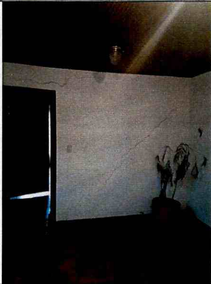
Fotografía 7. Fisuras y grietas en muros de cerramiento y divisorios de la edificación del costado norte del edificio Sonsoles ubicado en el predio de la Carrera 14 No. 92 – 16, en el Sector Catastral Chico Norte de la Localidad Chapinero.
