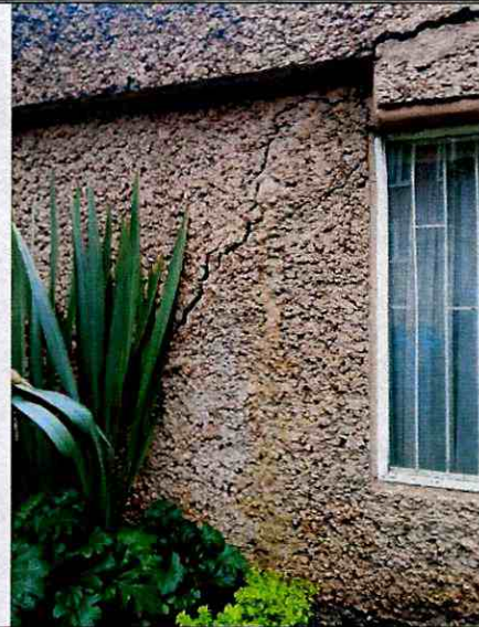
Fotografía 8. Fisuras y grietas en muros de cerramiento y divisorios de la edificación del costado norte del edificio Sonsoles ubicado en el predio de la Carrera 14 No. 92 – 16, en el Sector Catastral Chico Norte de la Localidad Chapinero.
