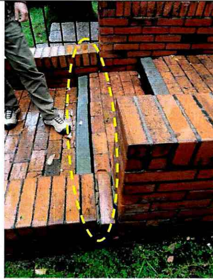
Fotografía 12. Separación entre adoquines del andén peatonal que sirve de acceso a la oficina ubicada en la edificación del costado norte del edificio Sonsoles ubicado en el predio de la Carrera 14 No. 92 – 16, en el Sector Catastral Chico Norte de la Localidad Chapinero.
