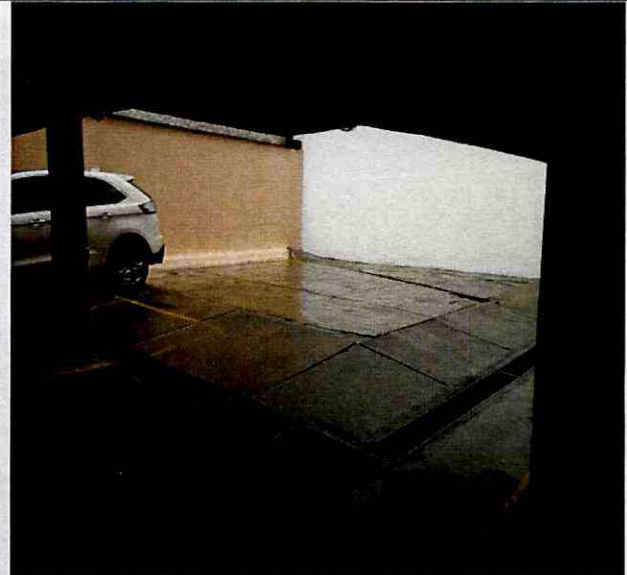
Fotografía 10. Deformaciones y hundimientos observados en la placa de contrapiso del sótano de estacionamiento de vehículos del edificio Sonsoles ubicado en el predio de la Carrera 14 No. 92 – 16, en el Sector Catastral Chico Norte de la Localidad Chapinero.
