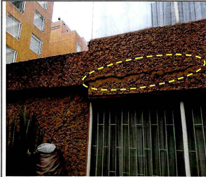
Fotografía 11. Grieta en muros de cerramiento de la edificación del costado sur del edificio Sonsoles ubicado en el predio de la Carrera 14 No. 92 – 16, en el Sector Catastral Chico Norte de la Localidad Chapinero.
